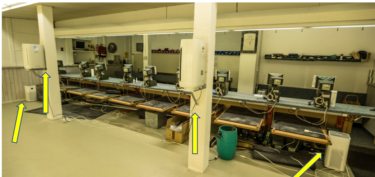
Abbildung 2 Um die Sicherheit vor Ansteckungen im Stand für Luftdruckwaffen zur erhöhen, sind Luftreinigungsanlagen installiert worden, welche Keime aus der Luft entfernen.
